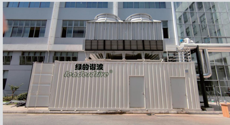
苏州绿的谐波集装箱式冷源模块 完成时间：2021年
