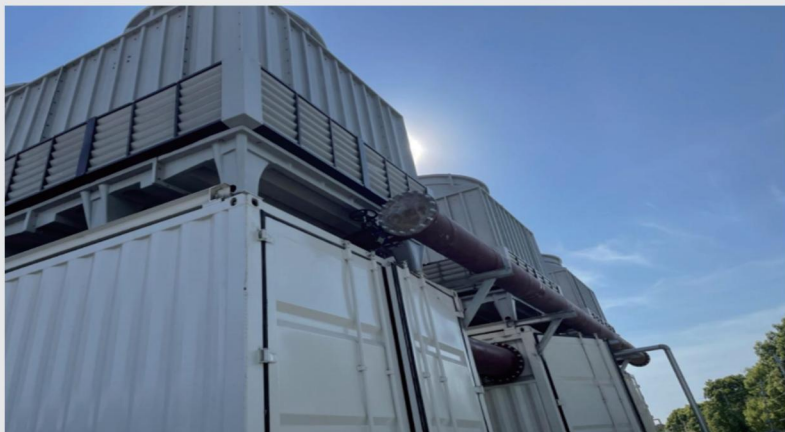
上海泰楚生物集装箱式冷冻站 完成时间：2022年
