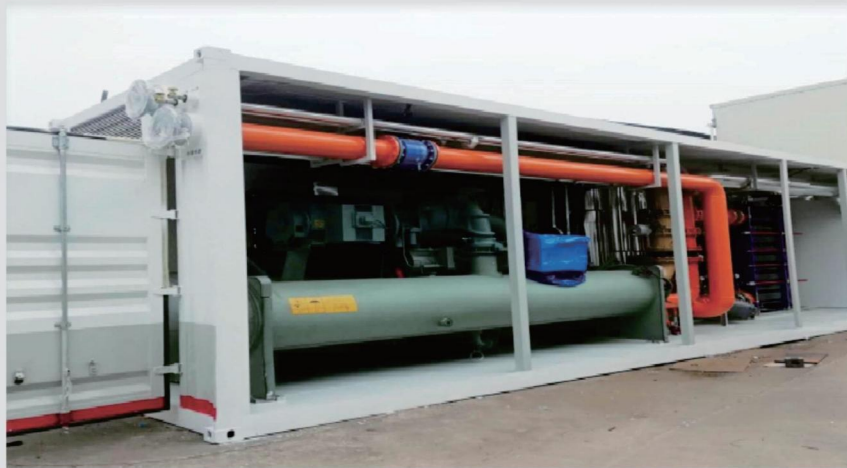
华为东莞云数据中心冷源模块 完成时间：2018年
