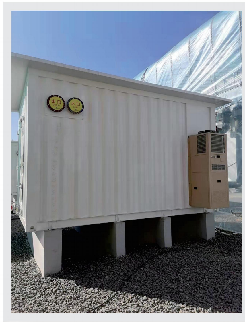
苹果贵安数据中心 完成时间：2022年
