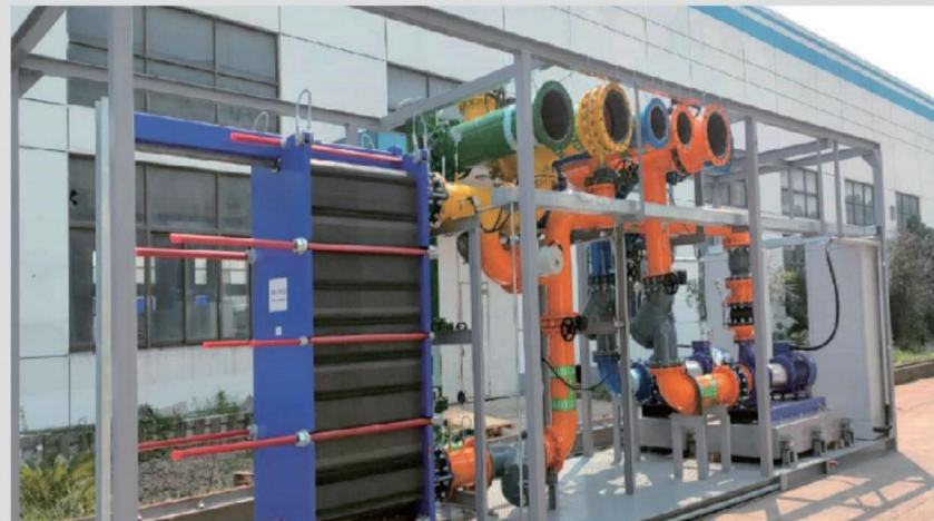
华为乌兰察布，廊坊数据中心冷源模块 完成时间：2020年
