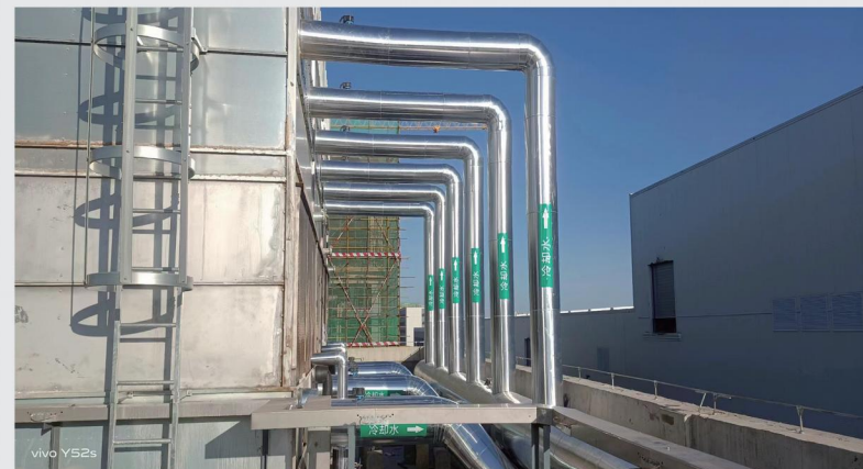
鄂尔多斯远景高效冷冻站 完成时间：2022年
