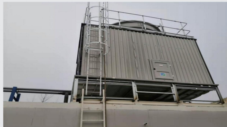
上海联合利华食品工厂冷源模块 完成时间：2022年
